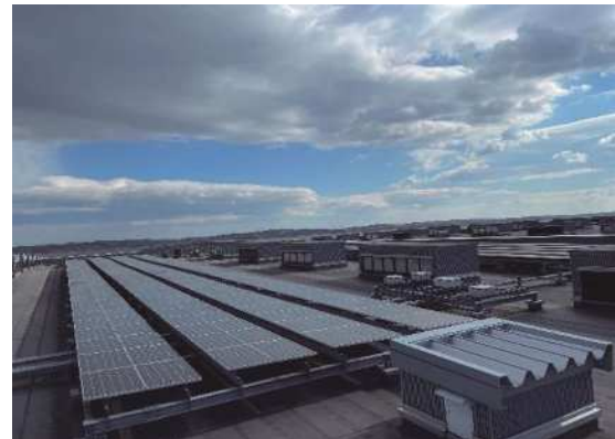
太陽光パネル
